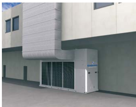
Liebert HPC-R, установленный снаружи
